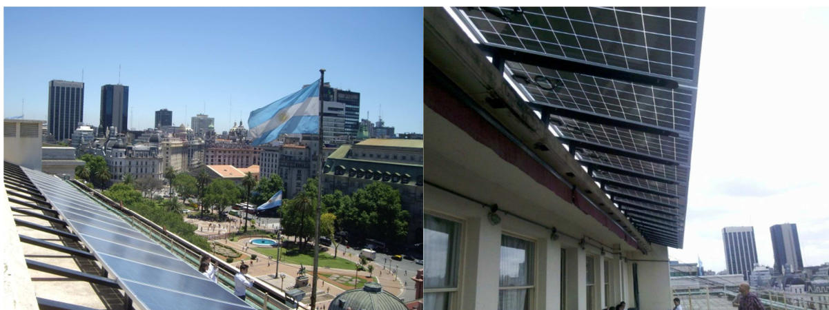
Figura 1: Vista superior e inferior del sistema fotovoltaico instalado en el Palacio de Hacienda.
